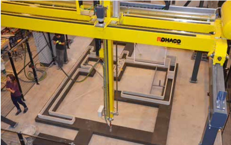
Op de TU/e in Eindhoven worden proeven gedaan om een 3D geprint huis te maken,
